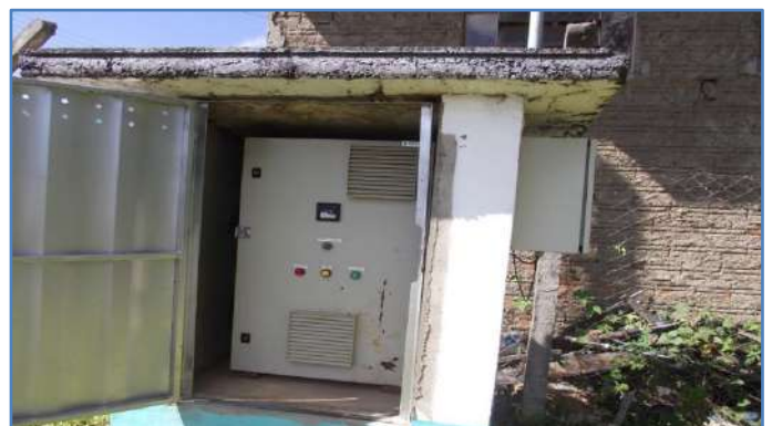
Imagem 22: Quadro de comando.
