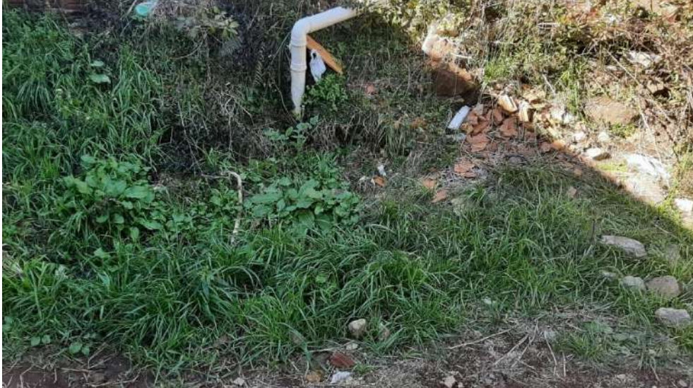
Figura 73: Tubulação de uma das residências interligada a fossa.
