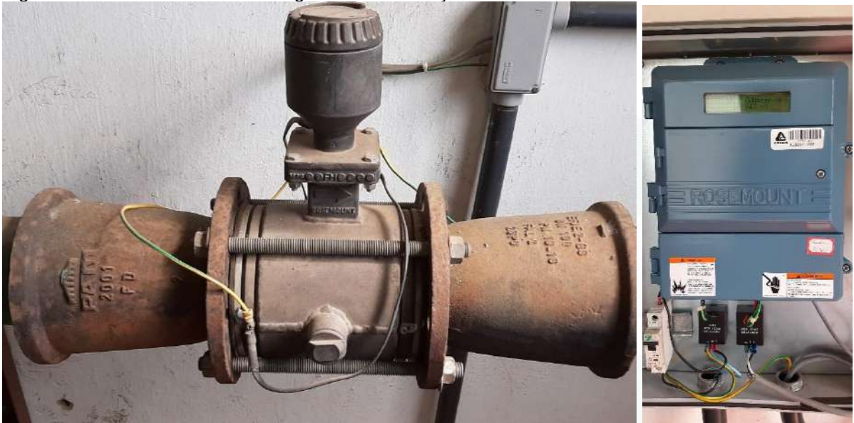
Figura 49: Macromedidor eletromagnético na tubulação entre a ERAT1 e o R1.
