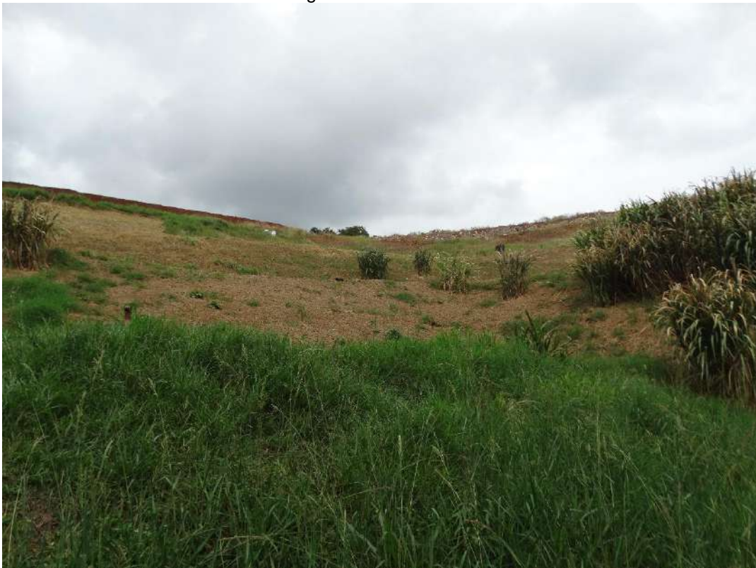
Figura 102: Ausência de sistema de drenagem.
