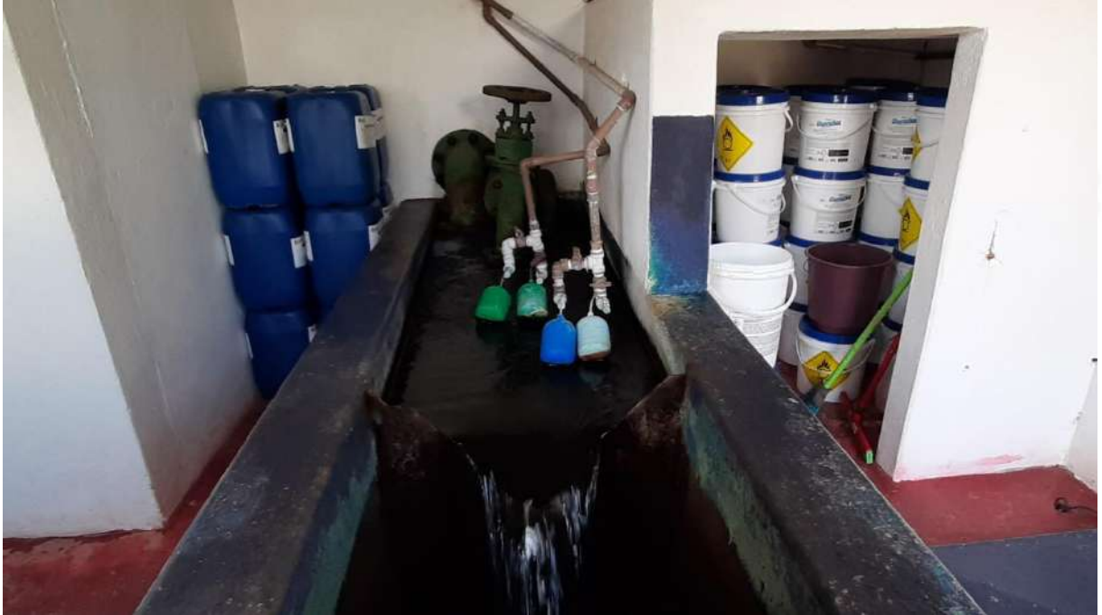
Figura 43: Calha vertedora na ETA 01 – Local de dosagem dos produtos químicos
