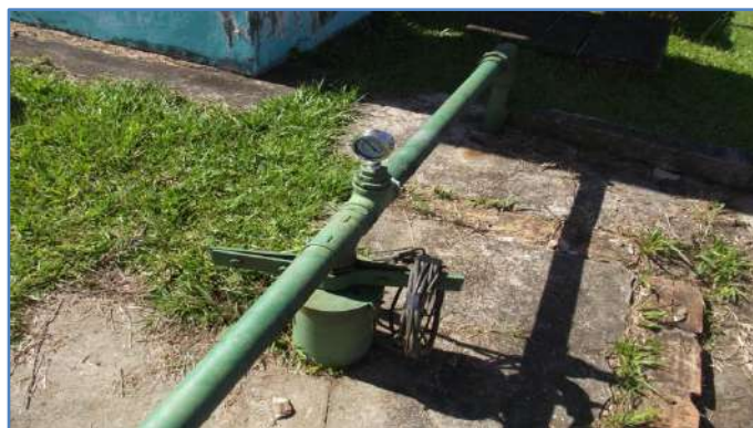
Imagem 7: Medidor de pressão na saída do poço.
