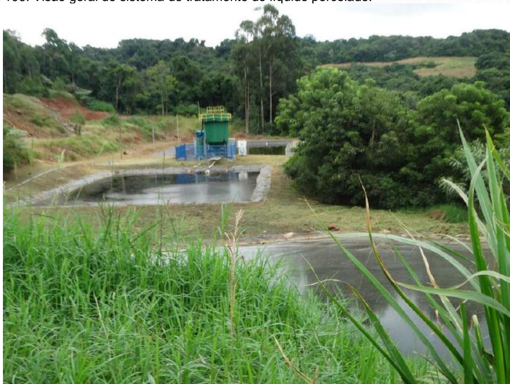
Figura 106: Visão geral do sistema de tratamento do líquido percolado.
