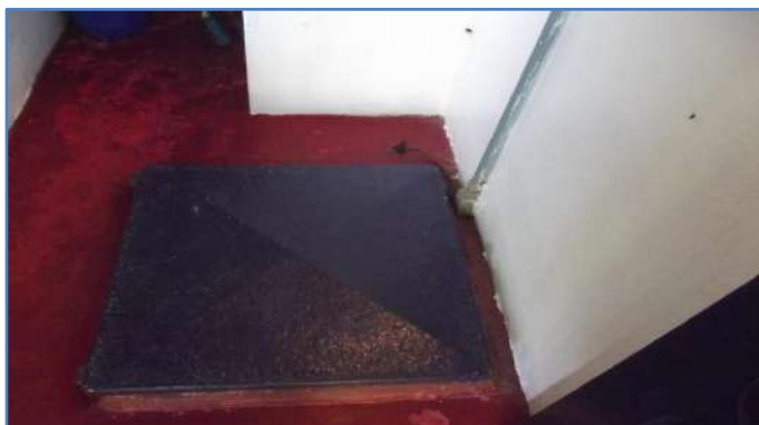
Imagem 31: Tampa de inspeção da câmara de contato.
