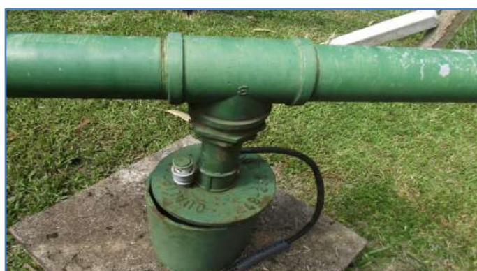
Imagem 27: Medidor de nível e instalação elétrica.
