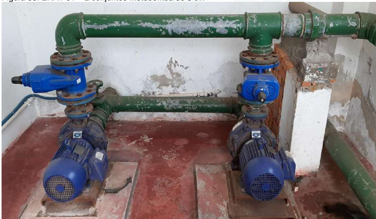
Figura 56: ERAT 01 – 2 conjuntos motobomba de 6 cv.
