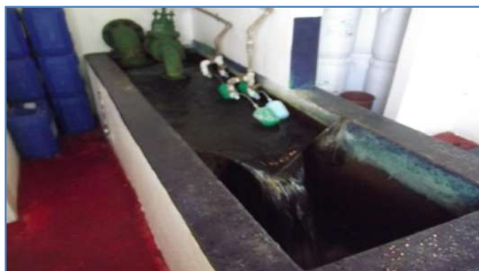
Imagem 30: Canal de chegada e dosagem de produtos químicos.
