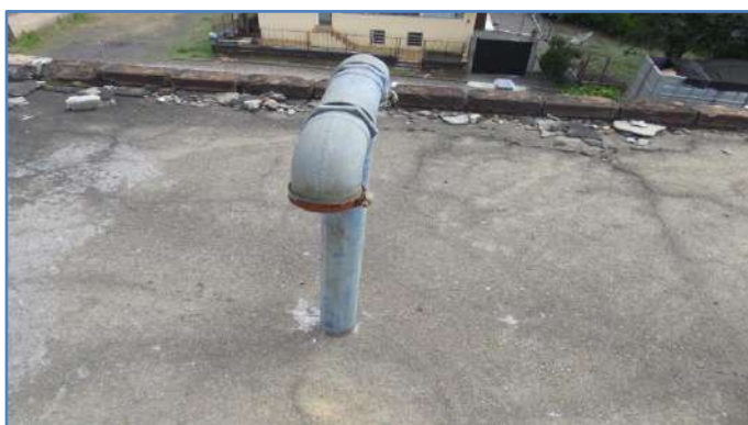
Imagem 63: Duto de ventilação.
