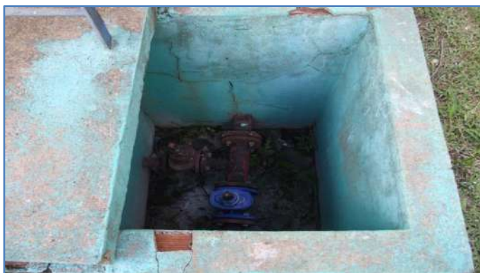
Imagem 61: Caixa de registro de manobra.
