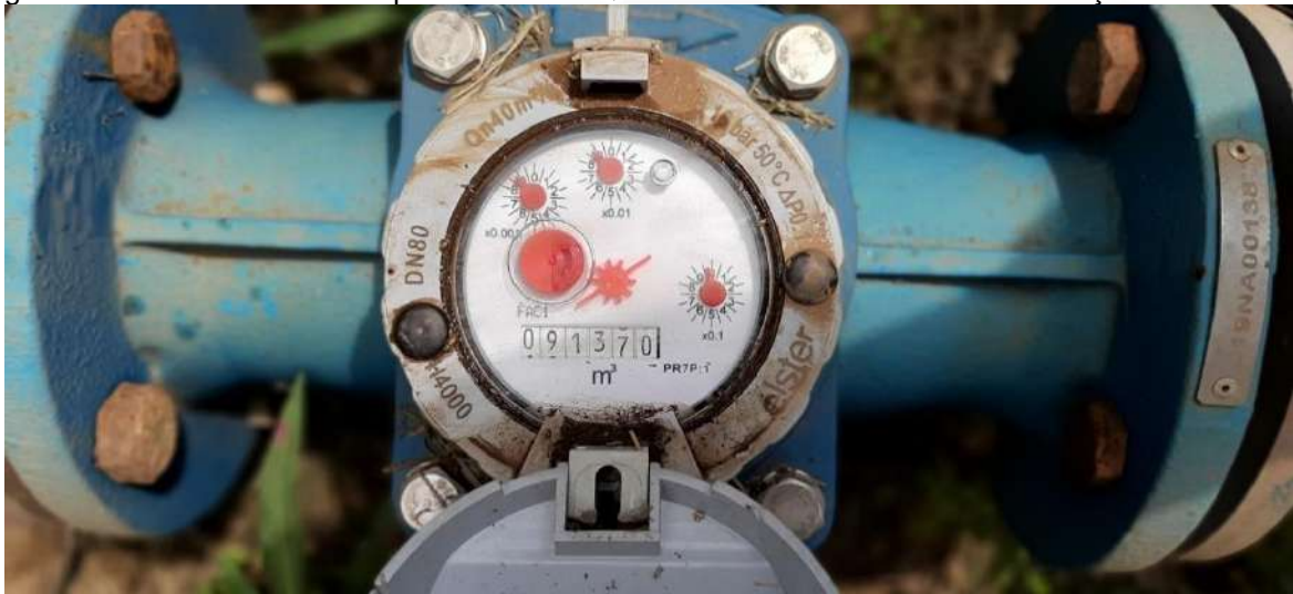
Figura 39: Medidor de Vazão Tipo Woltmann - Q_n 40\text{m}^3/\text{h} – instalado na saída do Poço 04.
