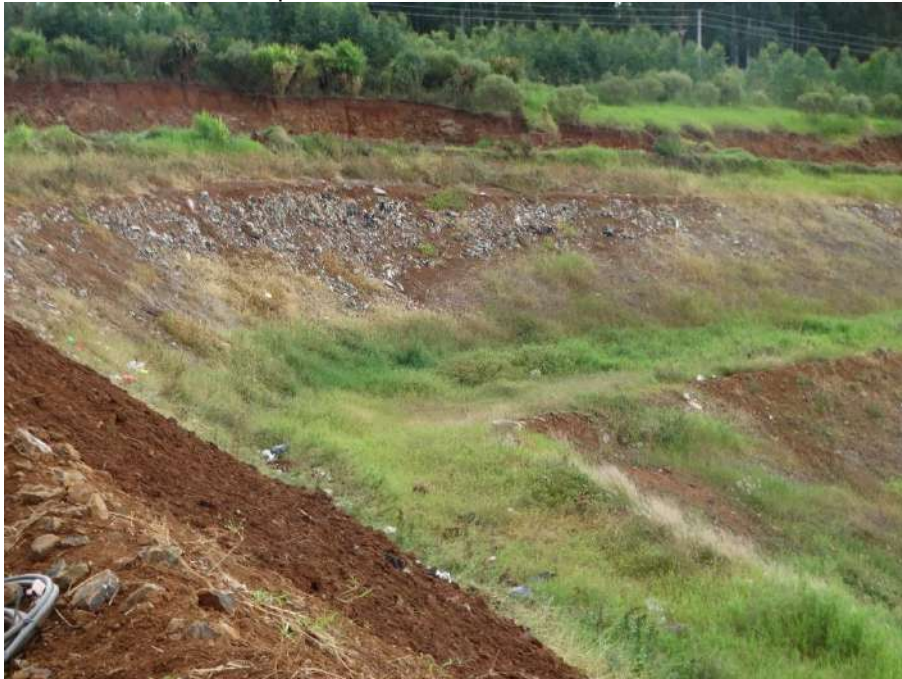
Figura 96: Cobertura final do aterro permitindo o contato do resíduo com o meio.
