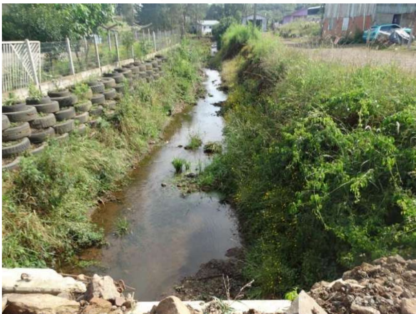
Figura 153: Muro de pneus construído próximo a margem córrego na Avenida Governador Ivo Silveira.
