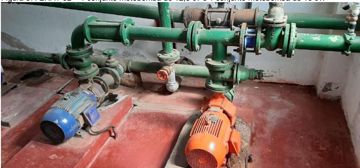
Figura 57: ERAT 02 – 1 conjunto motobomba de 12,5 cv e 1 conjunto motobomba de 10 cv.
