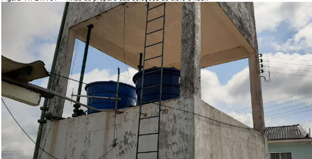
Figura 41: ETA 01 – Tinas de preparo das soluções de cloro e flúor.
