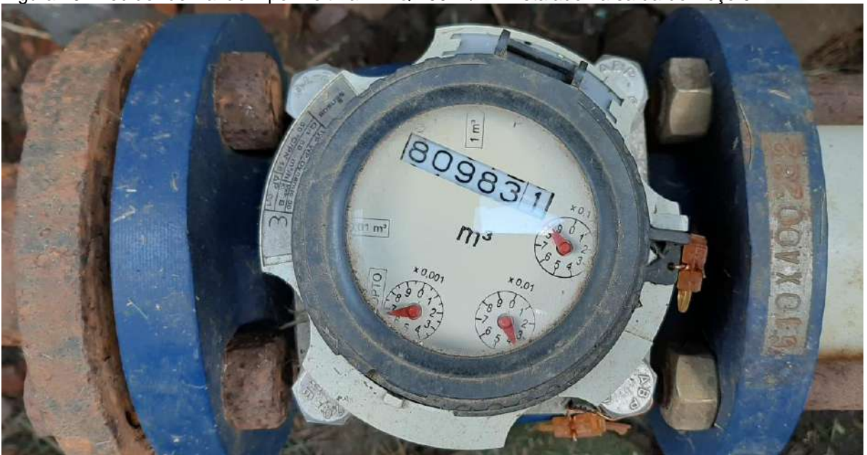
Figura 29: Medidor de Vazão Tipo Woltmann - Qn 50m 3 /h – instalado na saída do Poço 01.
