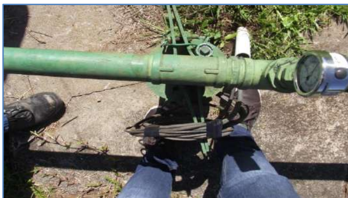
Imagem 6: Instalações hidráulicas do poço.
