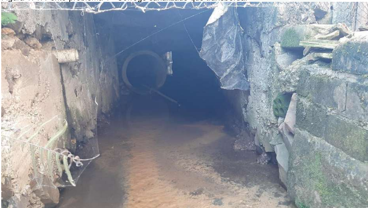
Figura 171: Ponto-problema 1 - Córrego canalizado que transborda.
