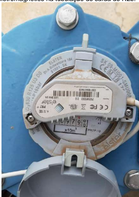
Figura 51: Macromedidor eletromagnético na tubulação de saída do R2b.
