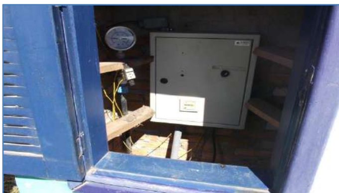
Imagem 16: Quadro de comando e medidor de pressão.
