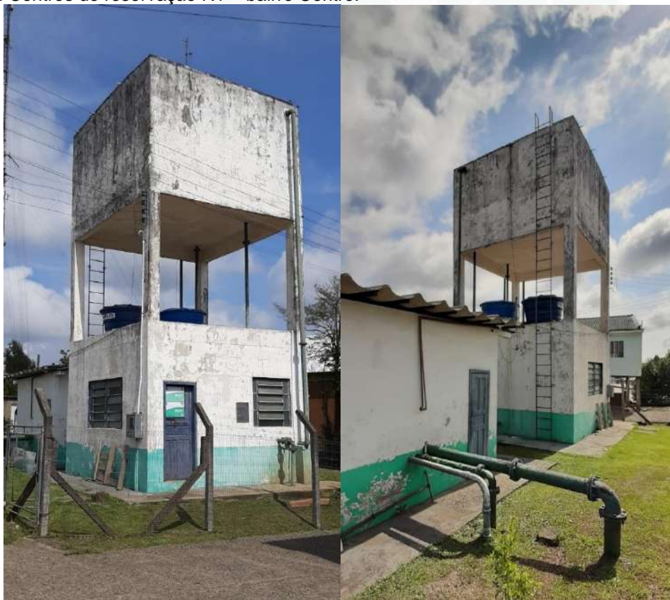
Figura 48: Centros de reservação R1 – bairro Centro.
