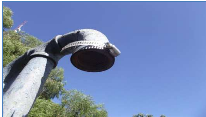
Imagem 50: Tela de proteção no duto de ventilação.
