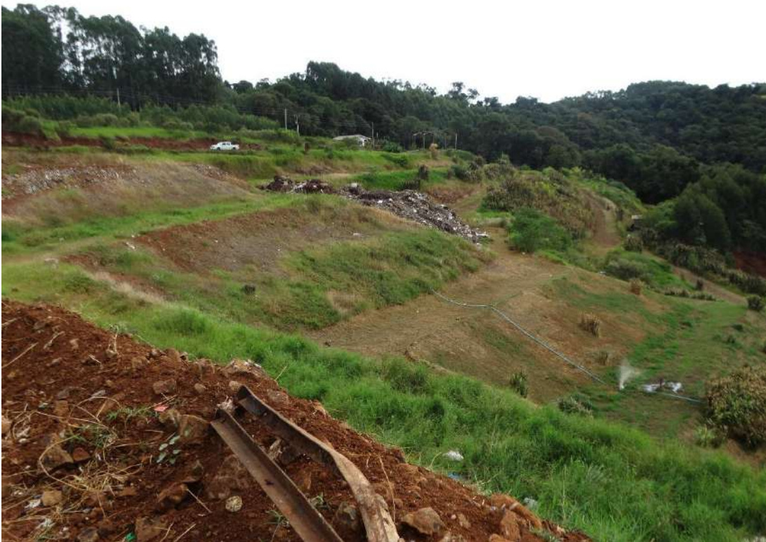
Figura 101: Ausência de sistema de drenagem.
