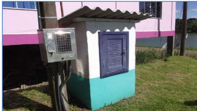
Imagem 15: Casa de quadro de comando.
