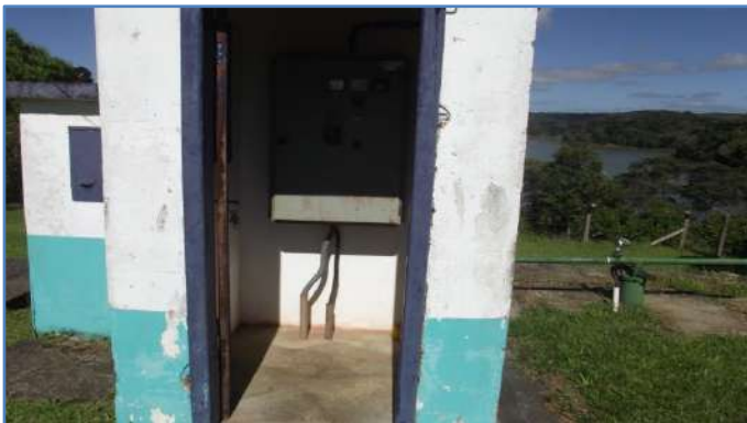
Imagem 4: Quadro de comando.
