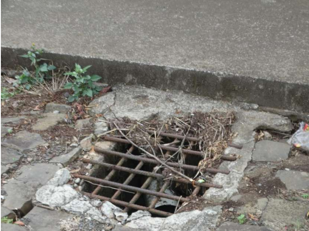
Figura 131: Modelo de grelha de boca de lobo existente no município.
