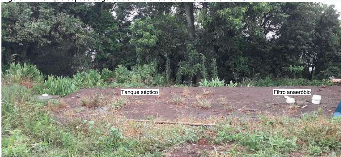
Figura 77: Tanque séptico seguido de filtro anaeróbio – SES Alto Irani 01.
