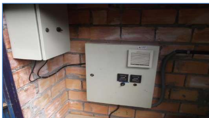
Imagem 24: Quadro de comando.
