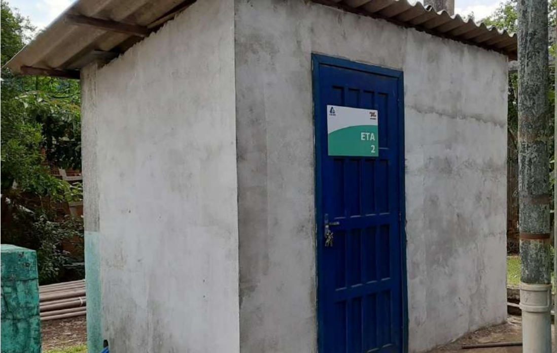
Figura 46: Unidade de tratamento simplificado - ETA 02.
