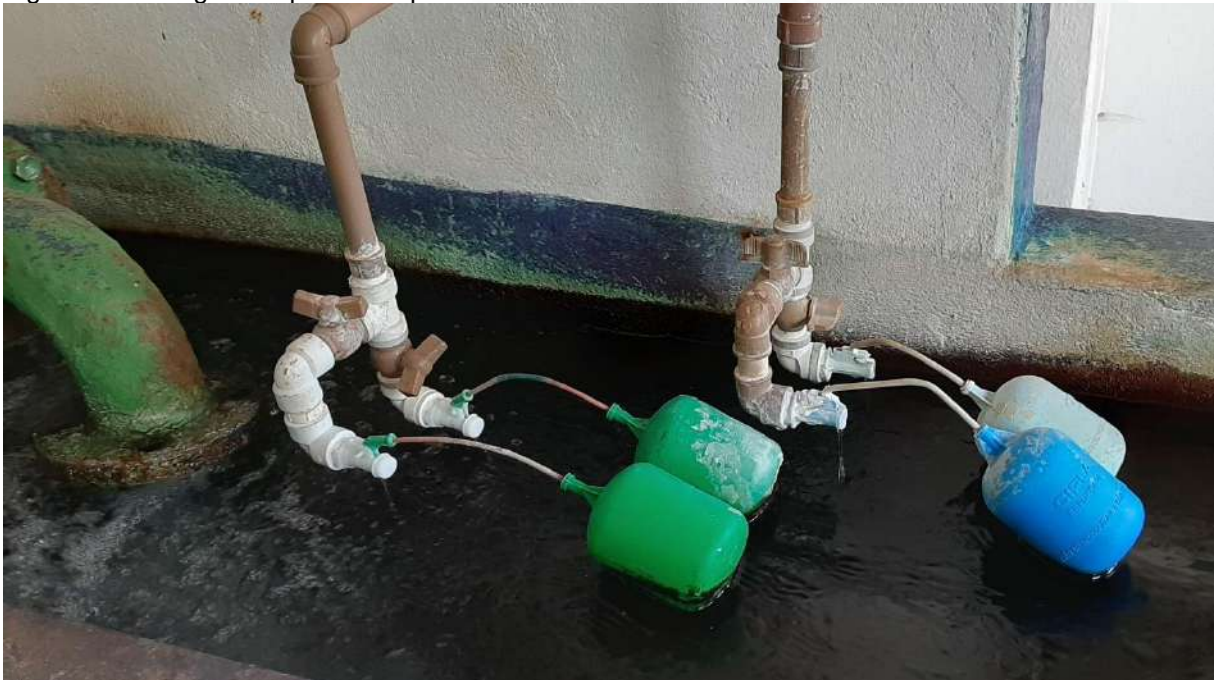
Figura 44: Dosagem de produtos químicos através de boias mecânicas
