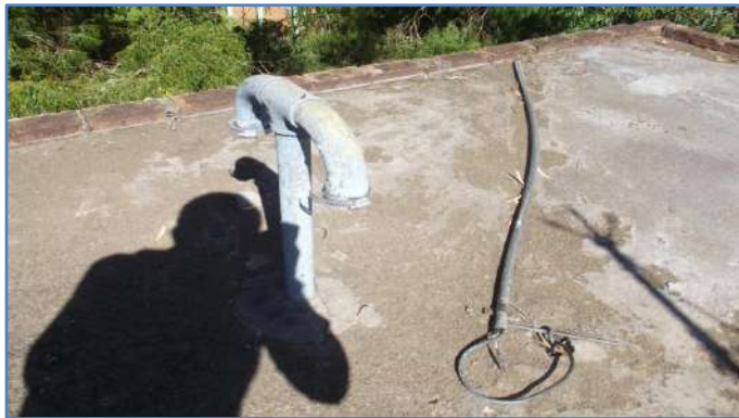
Imagem 49: Dutos de ventilação.
