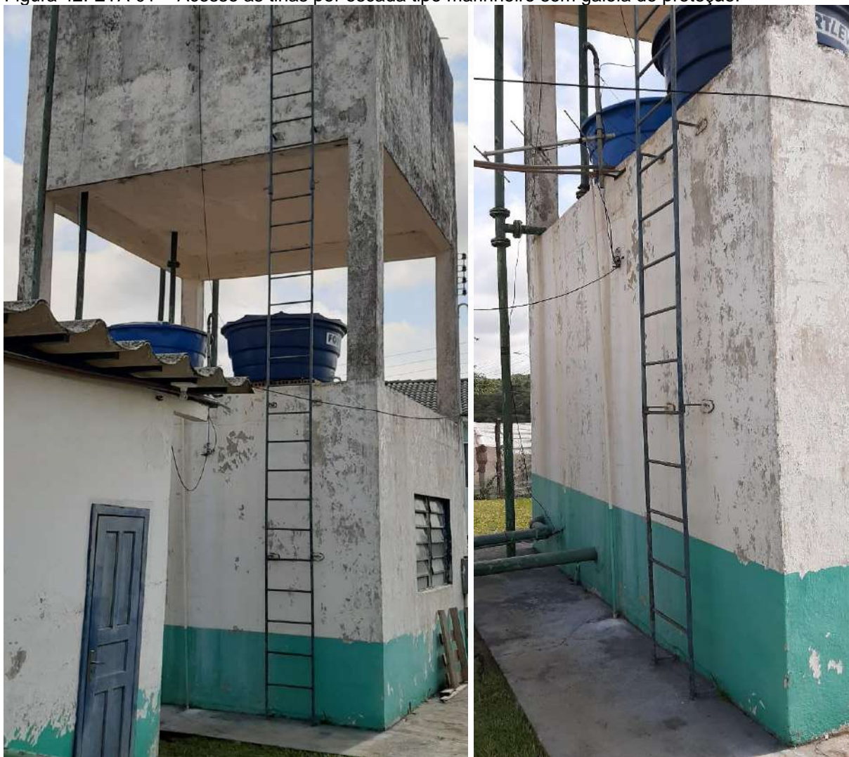
Figura 42: ETA 01 – Acesso as tinas por escada tipo marinheiro sem gaiola de proteção.
