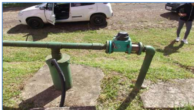
Imagem 11: Instalações hidráulicas do poço.
