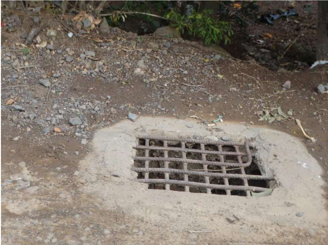
Figura 134: Modelo de grelha de boca de lobo existente no município.
