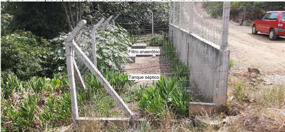
Figura 81: Tanque séptico seguido de filtro anaeróbio – SES Alto Irani 02.
