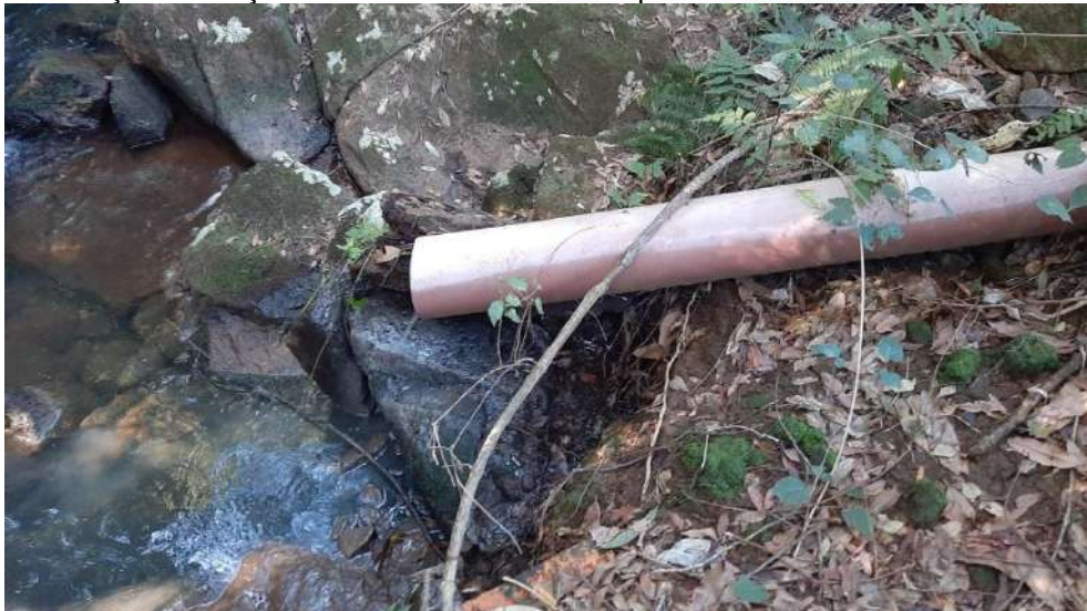
Figura 74: Tubulação de lançamento do efluente tratado após a fossa comunitária.
