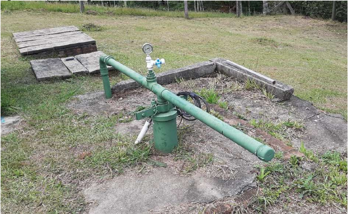
Figura 28: Captação de água subterrânea – Poço 01.
