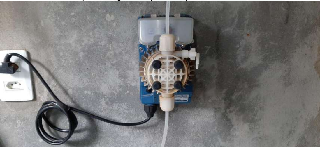
Figura 47: Bomba dosadora para dosagens dos produtos químicos – ETA 02.
