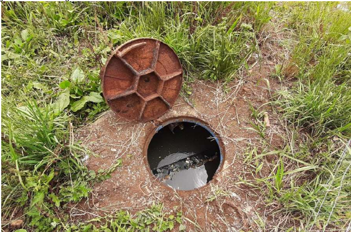
Figura 65: Caixa de gordura – SES Santo Antônio.
