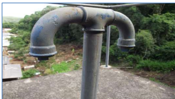
Imagem 55: Duto de ventilação.
