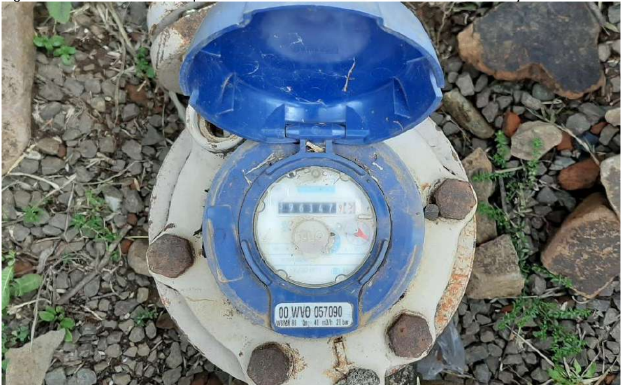
Figura 35: Medidor de Vazão Tipo Woltmann - Qn 40m³/h – instalado na saída do Poço 03.
