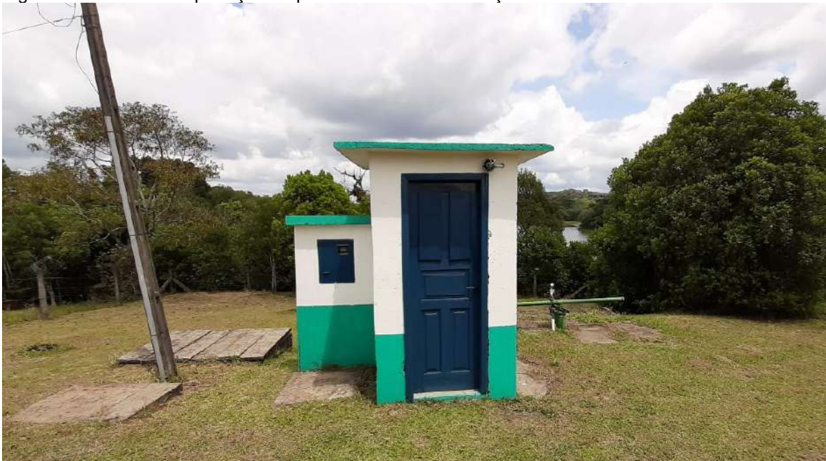
Figura 30: Estrutura de proteção do painel de comando – Poço 01.
