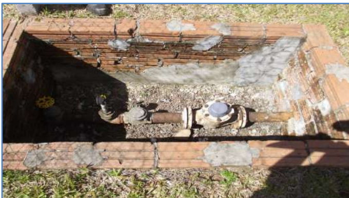
Imagem 19: Caixa de manobra de registros e medidor de vazão.
