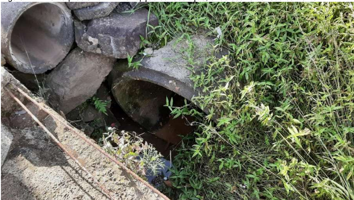
Figura 172: Ponto-problema 2 - Interrupção da tubulação, onde ocorre transbordamento.
