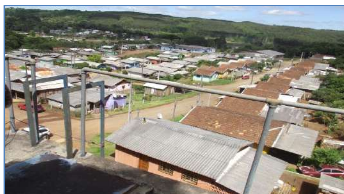
Imagem 53: Proteção lateral na cobertura.
