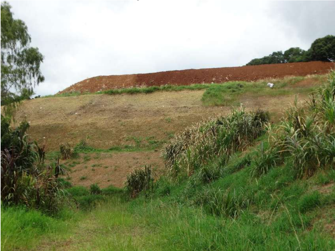
Figura 100: Ausência de sistema de drenagem.
