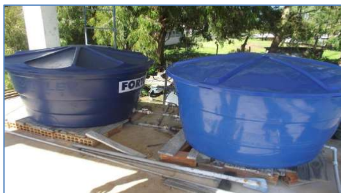
Imagem 36: Tina de preparo de cloro e flúor.
