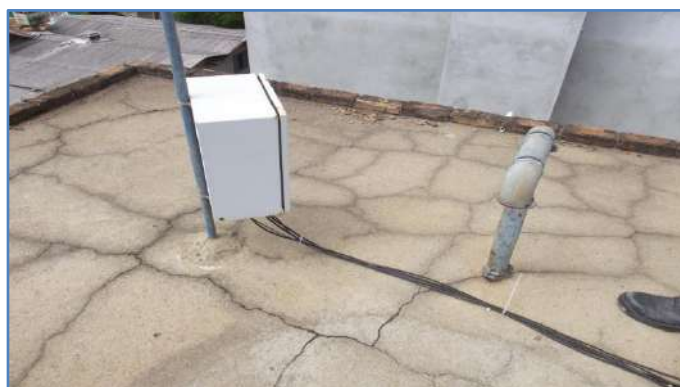
Imagem 64: Sistema de controle de nível via rádio frequência.
