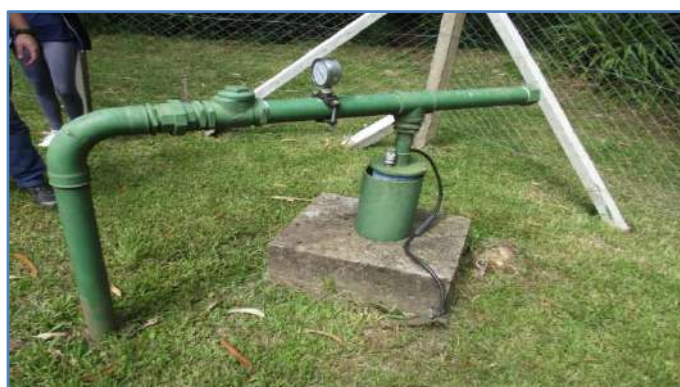
Imagem 26: Instalações hidráulicas do poço.
