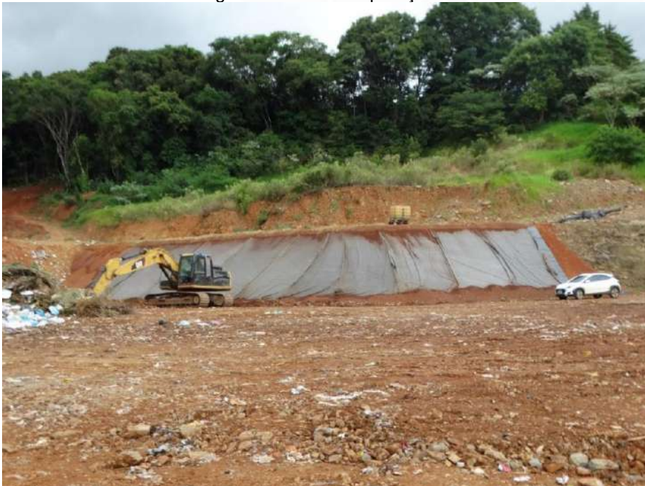
Figura 105: Ausência de dreno de biogás na célula em operação.
