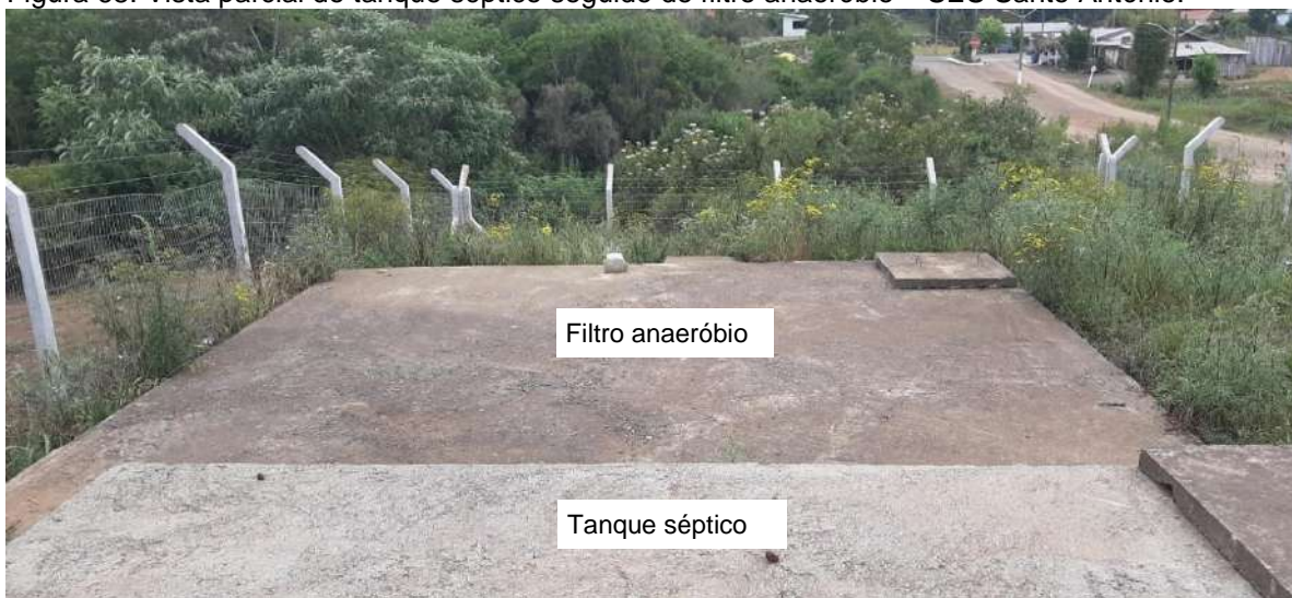
Figura 68: Vista parcial do tanque séptico seguido de filtro anaeróbio – SES Santo Antônio.
