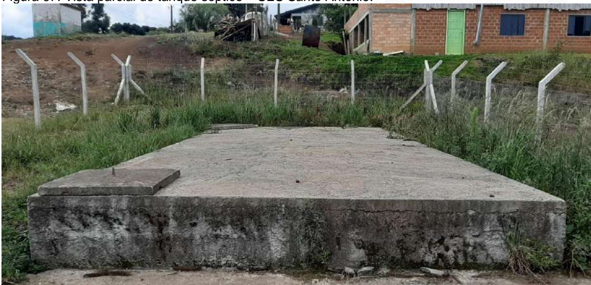
Figura 67: Vista parcial do tanque séptico – SES Santo Antônio.
