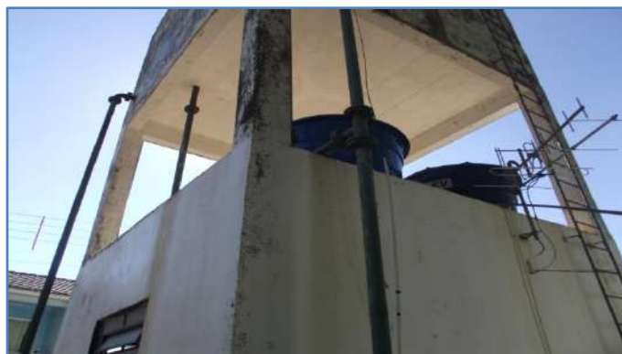
Imagem 46: Subida de água e estrutura de apoio do reservatório.
