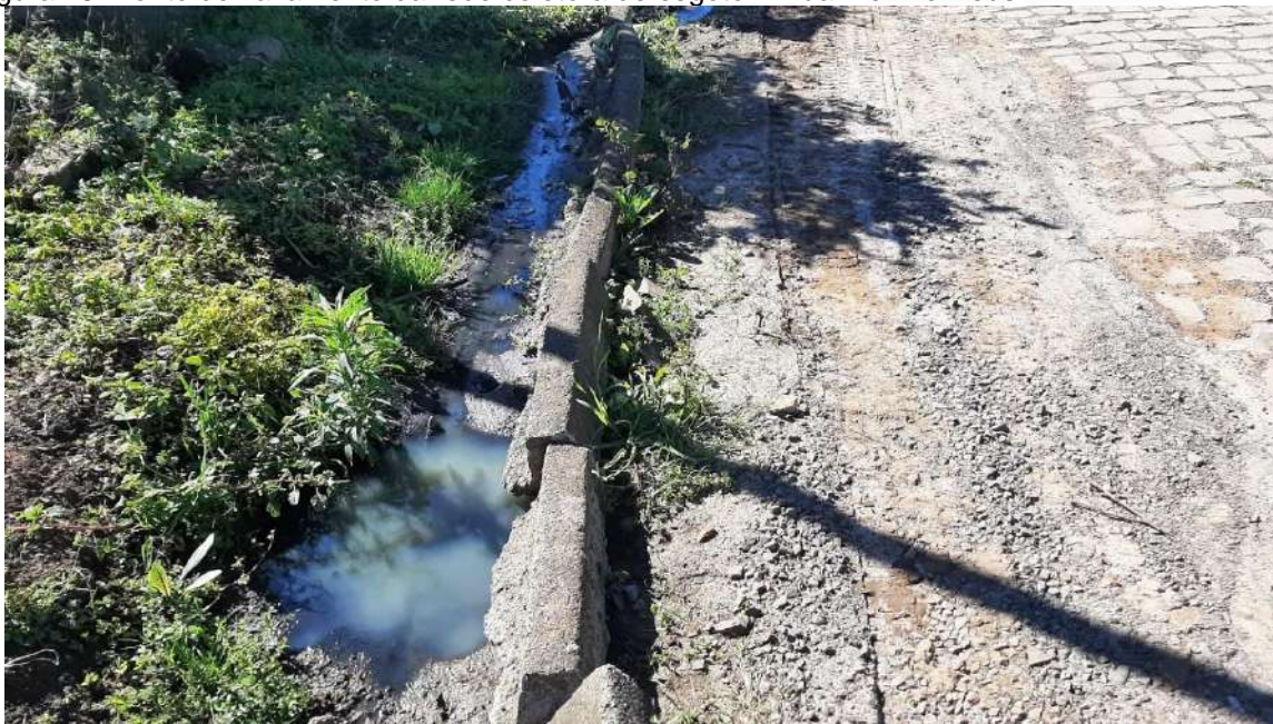
Figura 75: Ponto de vazamento da rede coletora de esgoto – Rua Menino Deus.
