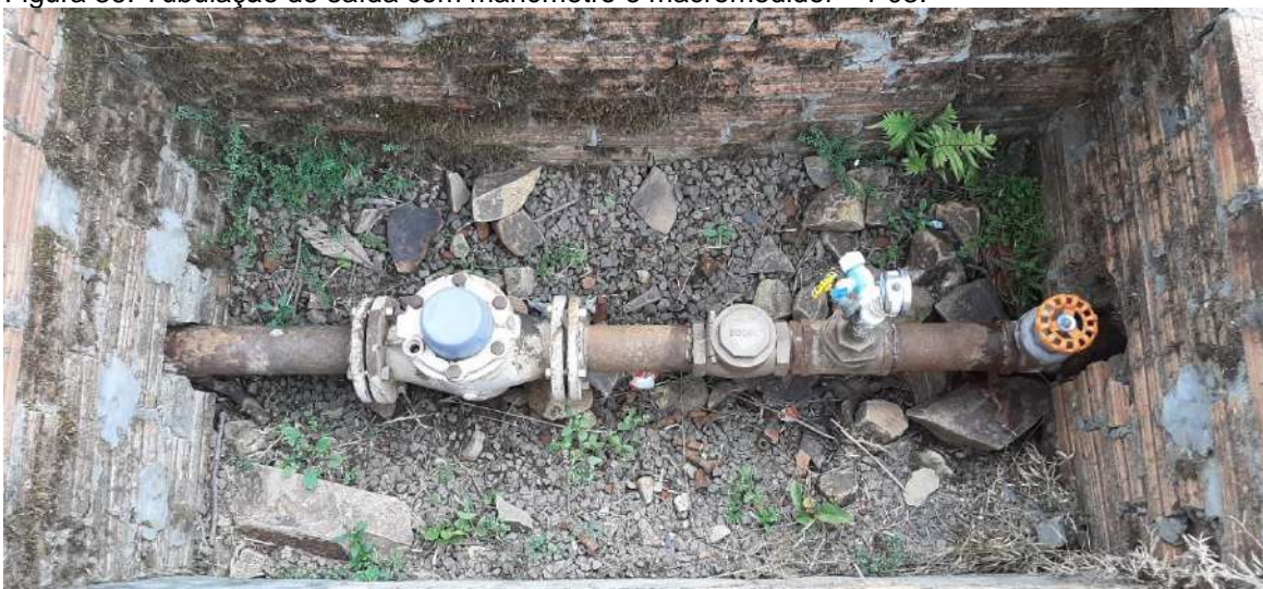
Figura 36: Tubulação de saída com manômetro e macromedidor – P03.
