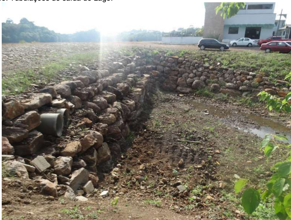
Figura 139: Tubulações de saída do Lago.
